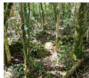
Figura 7.200. Estrutura colapsada do mangueiro de taipa de pedra. UTM 22J 500162/6957528. Foto e Acervo: Scientia, 2025.
